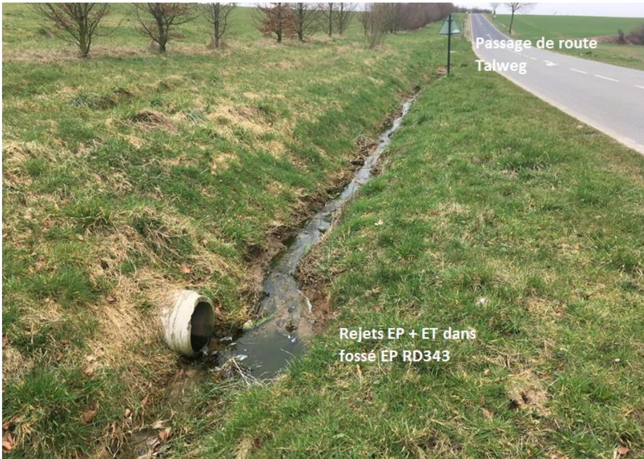
Photographie 6 : Vue du point de rejet unique du CVD au fossé de la RD 343
